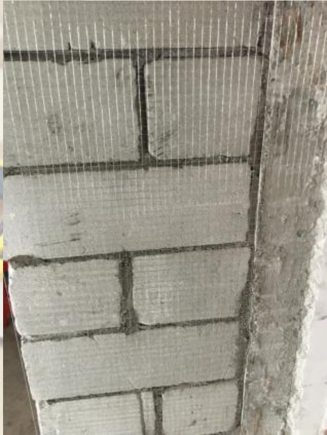
新老墙衔接处拆除老墙十五公分以上水泥砂浆层再进行挂网
